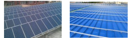
光伏支架系统
